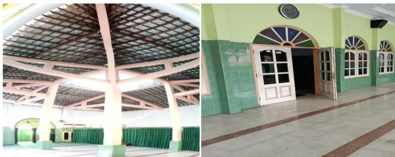
Gambar 3c. Kondisi kuda-kuda atap masjid dan keadaan kusen
