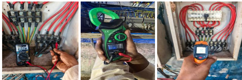
Gambar 5. Dokumentasi Pengukuran Tegangan Sistem MEP
